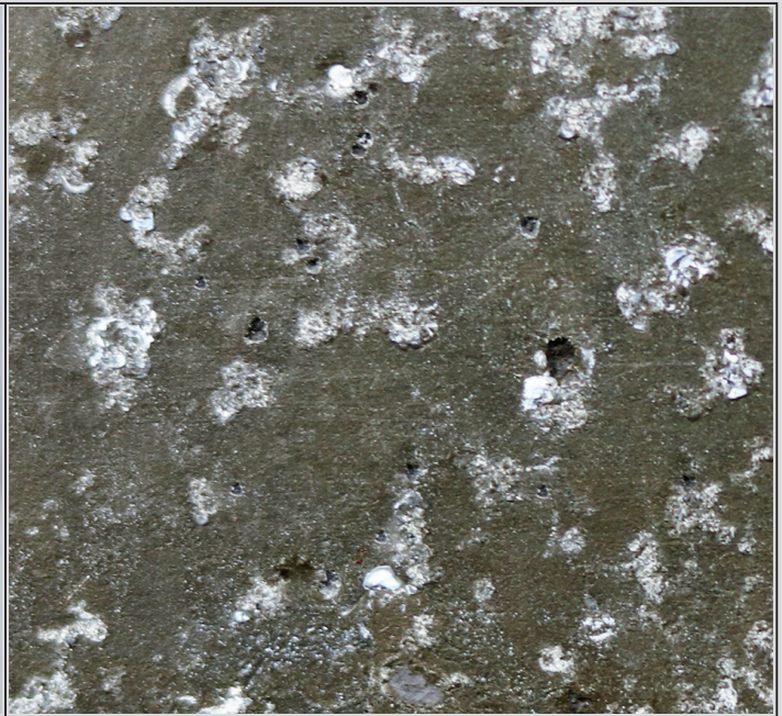
Detalles de la corrosión superficial
